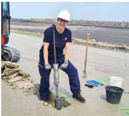
Paulina Gleichner bei der Probenahme an der Mineralischen Dichtung auf der Aschedeponie Jänschwalde II
